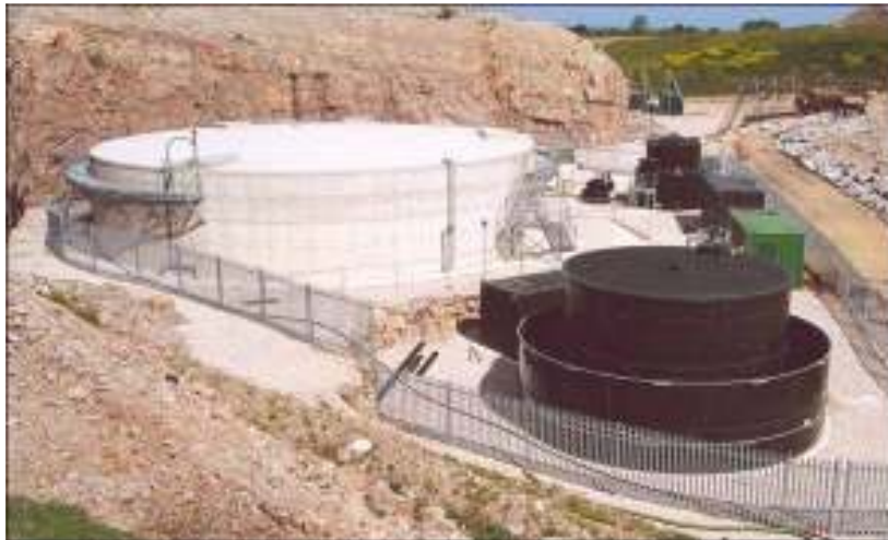
Plate 2. Llanddulas LTP, North Wales
